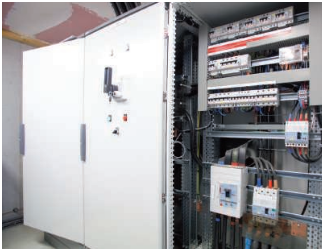
▲ Compacte et solide, l'armoire Altis abrite le TGBT.
