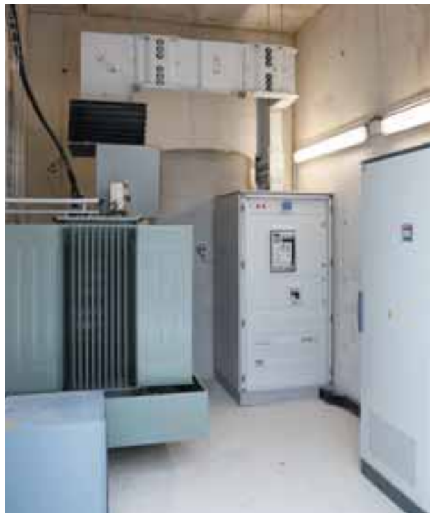
▲ Pour compenser l'énergie réactive, une batterie de condensateur a été installée.
