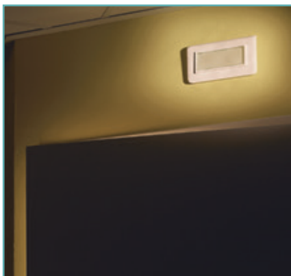
Hublot de signalisation lumineuse diffuse au-dessus de l'entrée des sanitaires (p.30).
