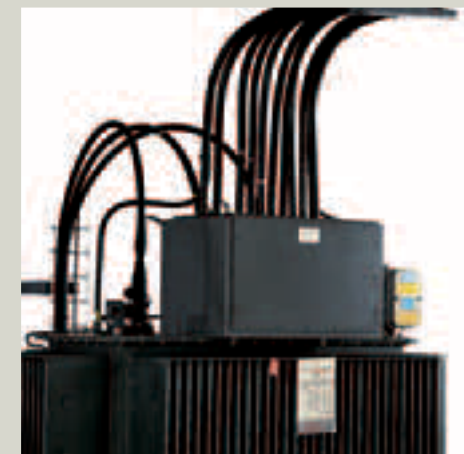
Départs en parallèle depuis un transformateur
