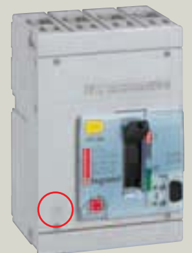
Les DPX sont livrés avec neutre repéré sur le pôle de gauche
