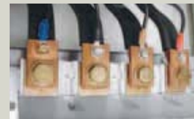
Exemple de raccordement sur plaquette cuivre rapportée sur la connexion. Les vis sont équipées de rondelles contre le desserrage
