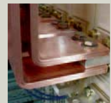
Raccordement de 2 barres de 80 x 10 sur chaque prise arrière d'un DMX 2500 débrochable
