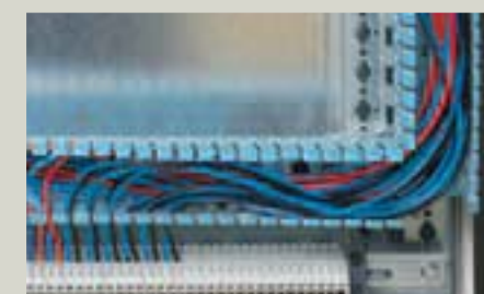
Plusieurs circuits dans une même goulotte et totalité du câblage en goulottes verticales et horizontales : cas de pose G
