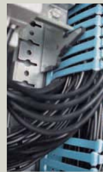
Circulations horizontales "à l'air libre", seuls les conducteurs verticaux sont collectés en goulottes : cas de pose U. Si comme ici, le taux de remplissage de la goulotte verticale est important : cas de pose G
